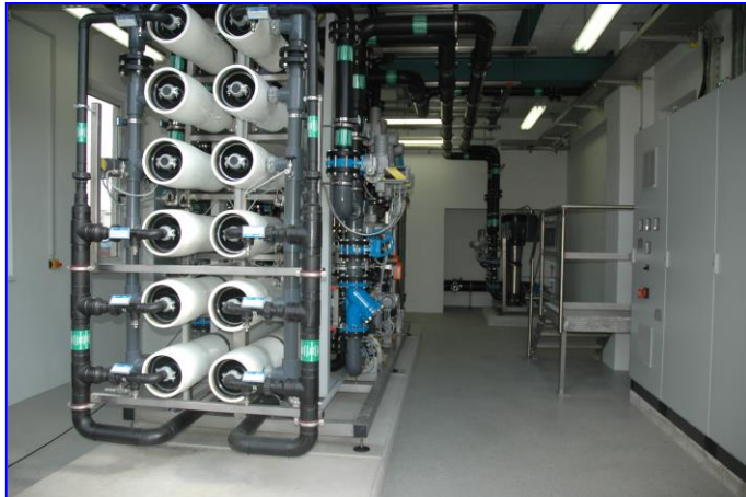
Bild 1: Nanofiltration zur Trinkwasserenthärtung
